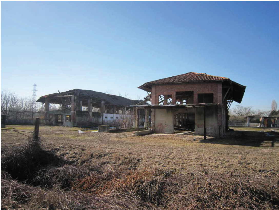
Vista interna delle corti da cui emerge lo stato di degrado degli immobili
