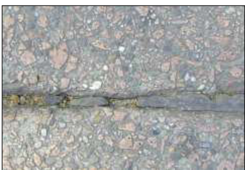
Figura 5: Degrado dei giunti precedentemente sigillati
