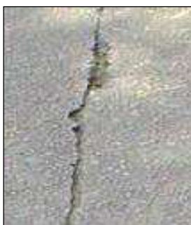
Figura 2: Esempio di fessurazione longitudinale
