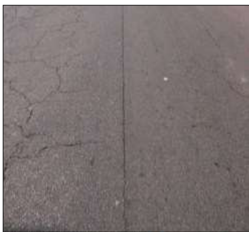
Figura 11: Fessura longitudinale da giunto di stesa.
