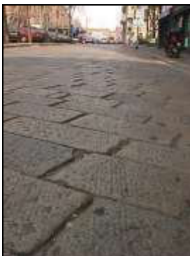
Figura 12: Eccessiva apertura dei giunti non sigillati
