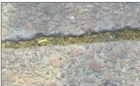
Figura 4: Degrado dei giunti non sigillati
