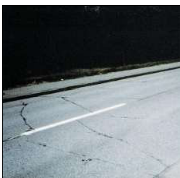
Figura 3: Esempio di fessurazione trasversale
