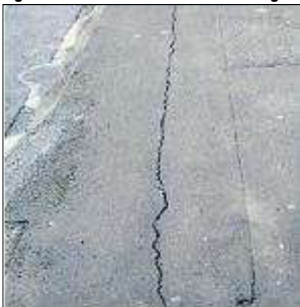
Figura 8: Esempio di fessura longitudinale
